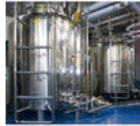
長万部工場plant
